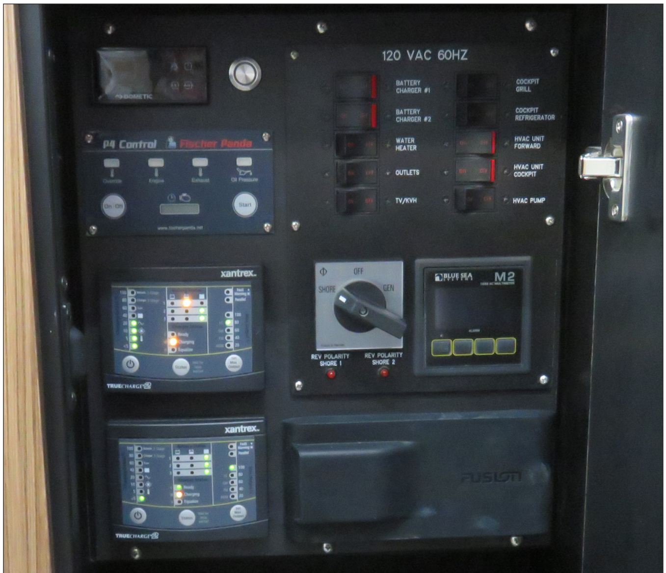
120 Volt AC Panel
