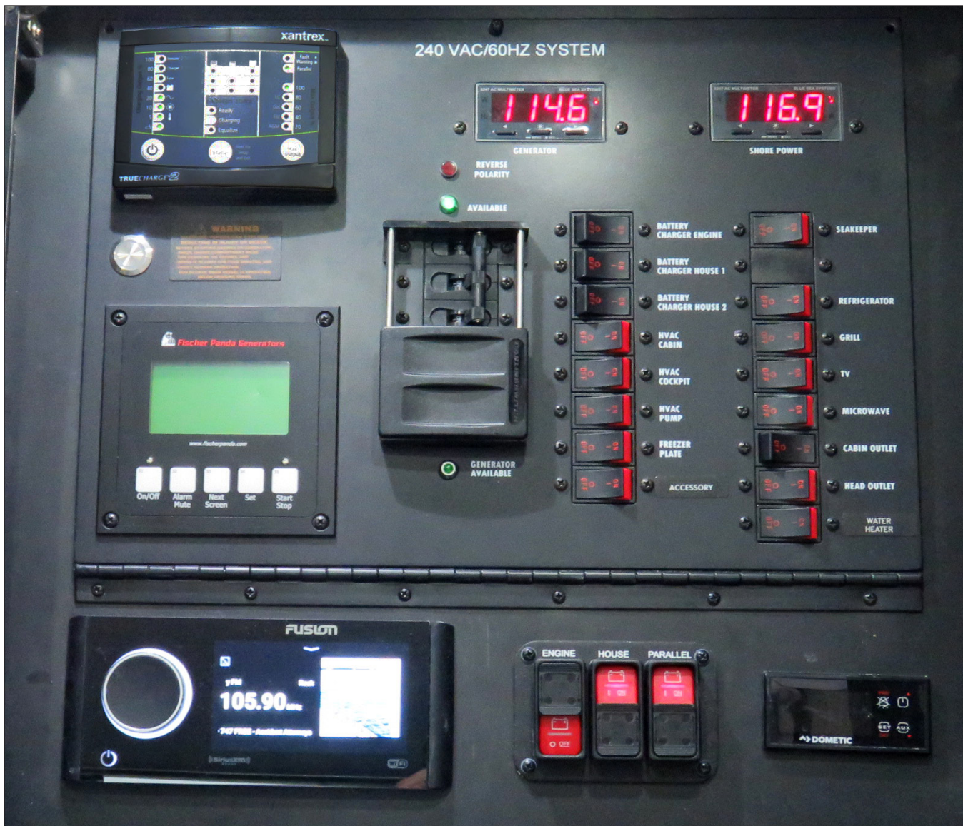
Cabin 120 Volt AC Panel
